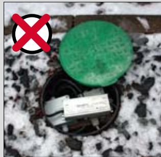
Netzteil ungeschützt im Bodenschacht Power supply unprotected inside the ground shaft Source d'alimentation sans protection dans un puits au sol
